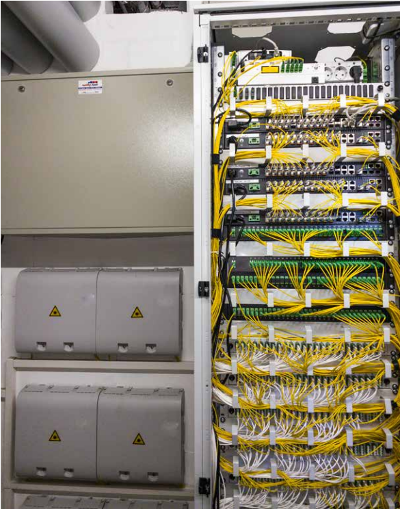
Abbildung 50: FTTH-Wohnanlage mit 100 WE, Nutzung von Glasfaser-Netzinfrastrukturen unterschiedlicher Anbieter; Netzkomponenten für PON (links) und PtMP mit aktiver Technik für IP und DVB-C/CATV (rechts)
