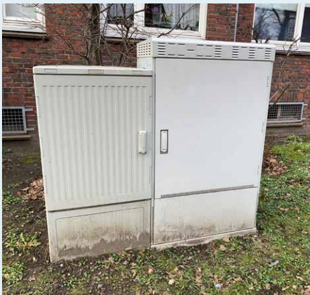
Abbildung 31: zentraler Infrastrukturpunkt Außenschrank (Außenansicht)
