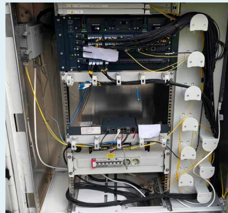
Abbildung 32: zentraler Infrastrukturpunkt Außenschrank (Innenansicht)
