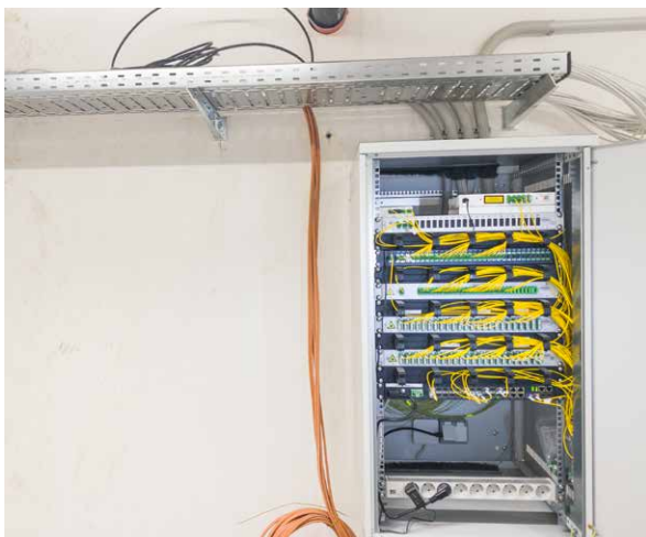
Abbildung 48: Gebäudeverteiler mit Kabelführungssystem
