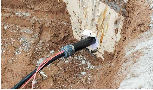
Abbildung 28: Mehrspartenhauseinführung an der Gebäudeaußenwand
