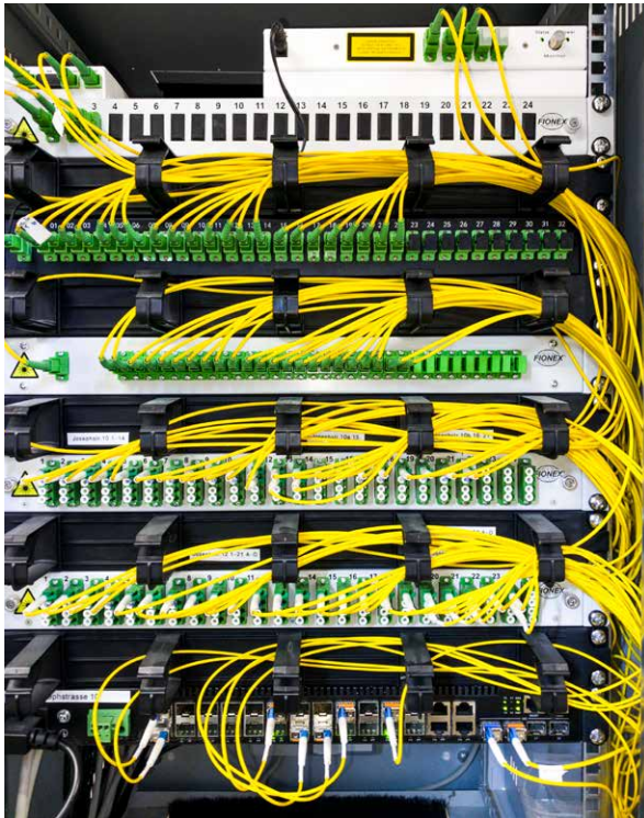
Abbildung 47: Aktiver PtMP-Gebäudeverteiler mit Patchfeldern
