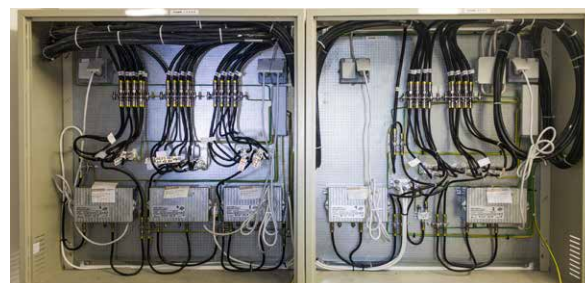
Abbildung 43: Koaxial-Gebäudeverteiler für 24 WE (oben) bzw. 36 WE (unten)
