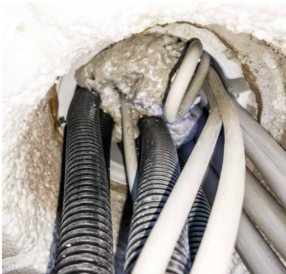
Abbildung 65: Brandschottung von Elektroinstallationsrohren und Kabeln in einem Steigschacht
