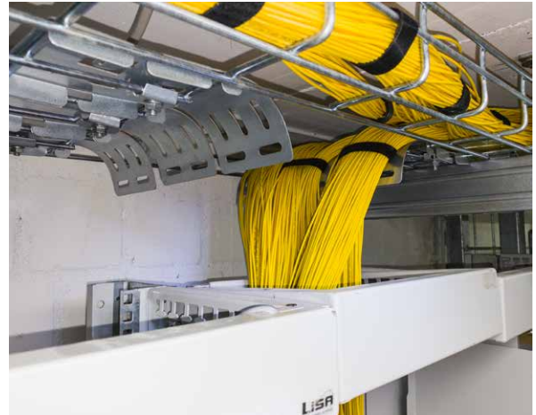
Abbildung 49: Glasfaserkabel-Verteilung über Kabelführungssystem
