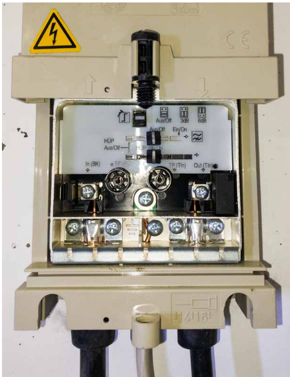
Abbildung 35: HFC-ÜP im geschlossenen und geöffneten Zustand (koaxiale Verkabelung)
